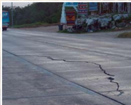
La carretera 307 que va de Chetumal a Cancún atraviesa la Riviera Maya; ésta soporta una gran carga vehicular incompatible con la naturaleza porosa del suelo. En la foto se observan vacíos en la roca lo que representa un riesgo potencial de colapso. Fotógrafo. Olmo Torres
